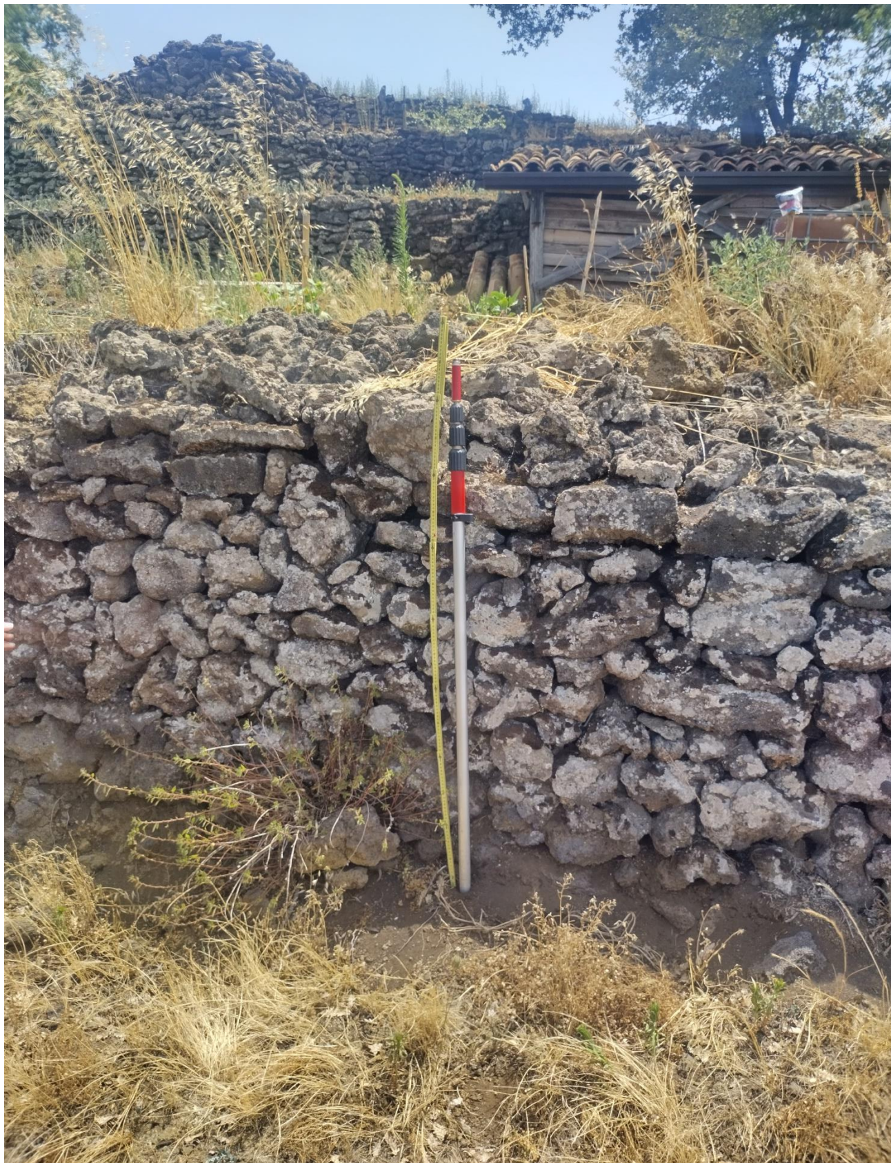
Foto tratto Muro n° 1 ( H. min 1.10 a H. max 1.70 ) H. media 1.30/1.35
